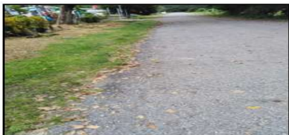
Fotografía 2: Ausencia de construcción de cunetas.
